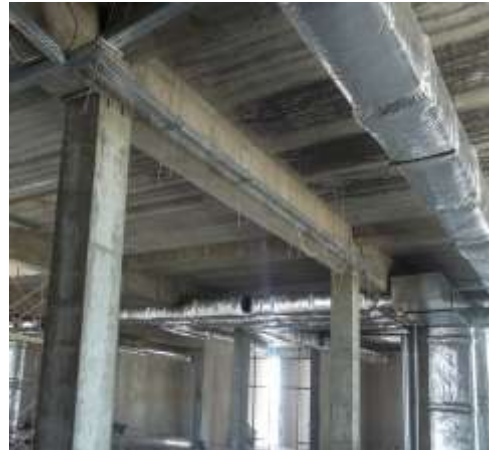
Система воздуховодов и вентиляции
