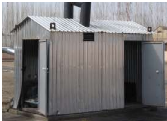
Фрагмент модульной котельни
