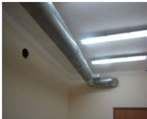
Система воздуховодов вентиляции
