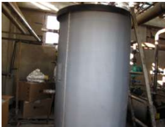
Оборудование для ГВС и отопления
